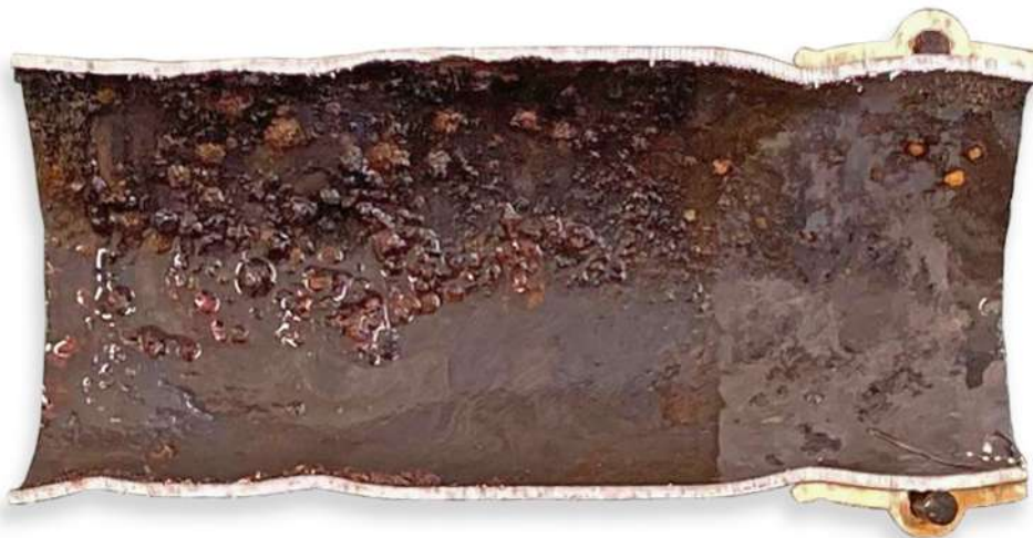
Fig. 6: Immagine del danno dovuto a corrosione da ossigeno all'interno di un tubo in acciaio.
